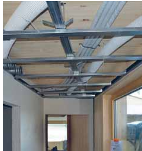
Abbildung 106: Abgehängte Decke im MFH Kirchrainweg mit nicht in Betondecke eingelegten Lüftungs- und Elektrorohren als Beispiel für Systemtrennung (Foto: aardeplan).
